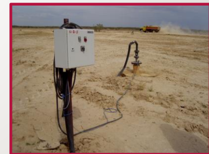
Bombas de alimentación en minería ISL, Asia Central
