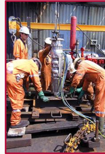
Bombas de toma de agua de mar en plataformas marinas, África occidental
