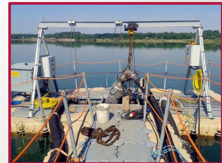
Bombas de transporte para bombear aguas agresivas de una mina residual a cielo abierto, Alemania
